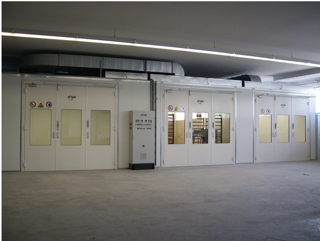
v.r.n.l. Washkabine – Lackiereinrichtung – Trockenraum
